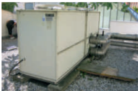
Stand vor der Sanierung: Luftgekühlte R22-Kältemaschine in Außenaufstellung unter der Laubkuppel.
